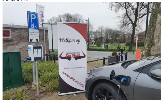
Foto laadpaal, inmiddels in gebruik. Mede mogelijk gemaakt door Blue Current
